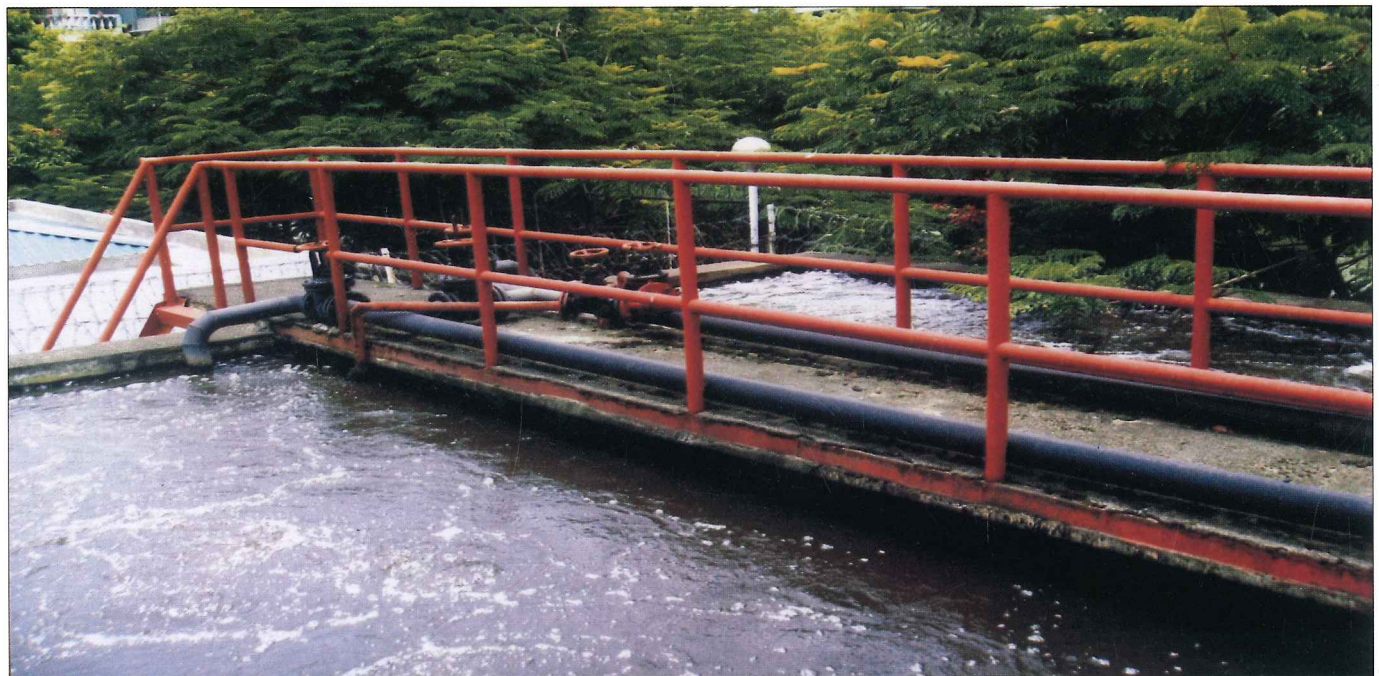
↓ Hệ thống xử lý nước tại Đại sứ quán Liên Bang Nga tại Việt Nam Water Treatment of Russian Embassy in Vietnam
